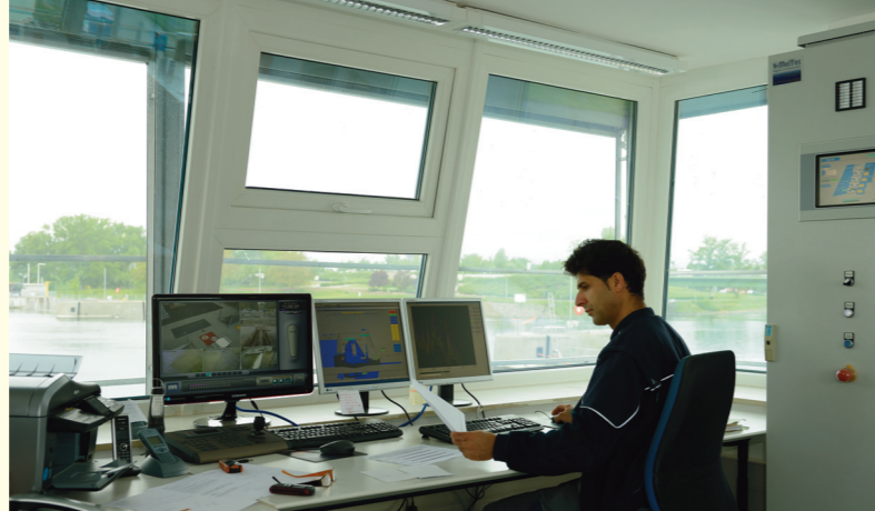
Zentraler Steuerstand des Kulturwehres
